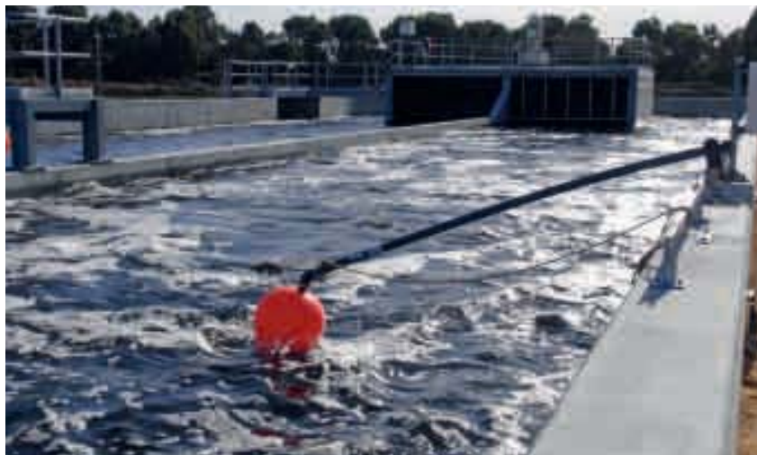
Een on line analyser in een beluchtingstank.
